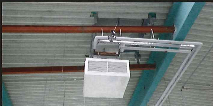
Zuluftauslasskasten unter der Decke einer Fertigungshalle. Die vorgewärmte Zuluft aus dem Dachwärmerückgewinner wird mit einem zusätzlichen Heizregister über dem Auslasskasten auf die Solltemperatur nacherhitzt.
