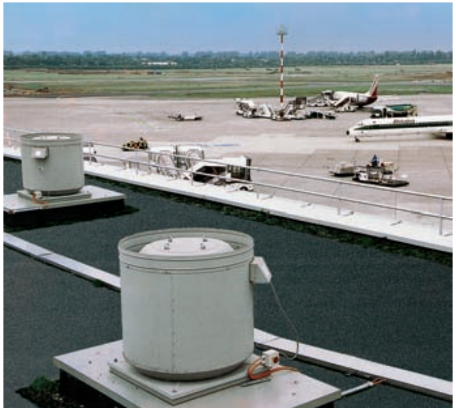
Bild 1: Entrauchungs-Dachventilatoren (Flughafen Düsseldorf)
