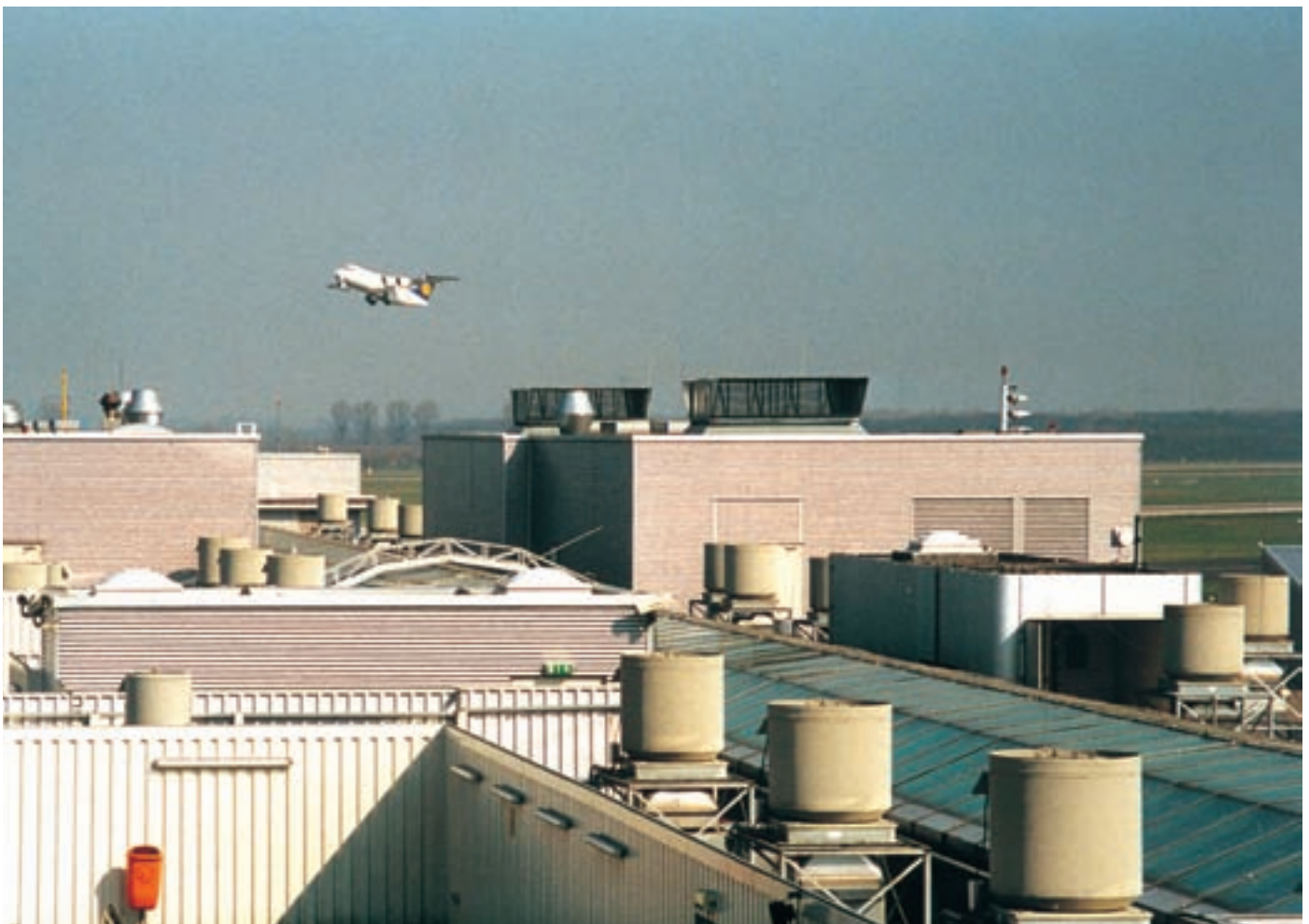
Flughafen Düsseldorf: Terminal 2 (Entrauchungs-Dachventilatoren)
