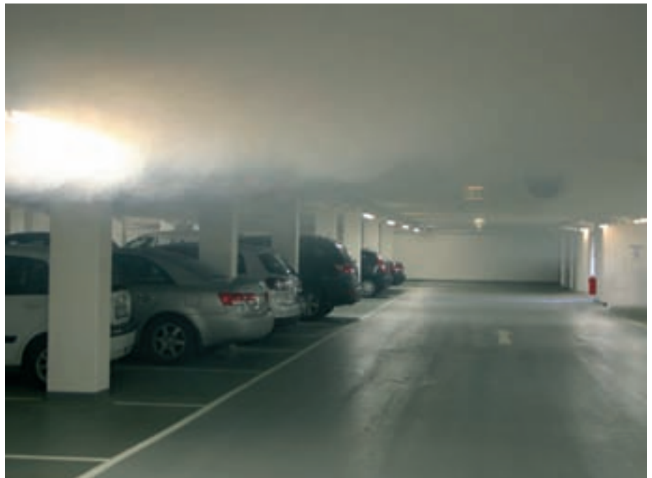
Bild 10: Der Rauch verteilt sich gleichmäßig unterhalb der Decke und die Ventilatoren sind in Betrieb. Rauchversuche in der Tiefgarage der Europazentrale von Hyundai in Offenbach/Main
