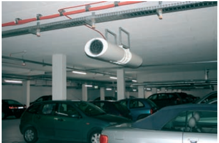
Bild 1: Jet-Ventilator in der Tiefgarage der Europazentrale von Hyundai in Offenbach/Main
