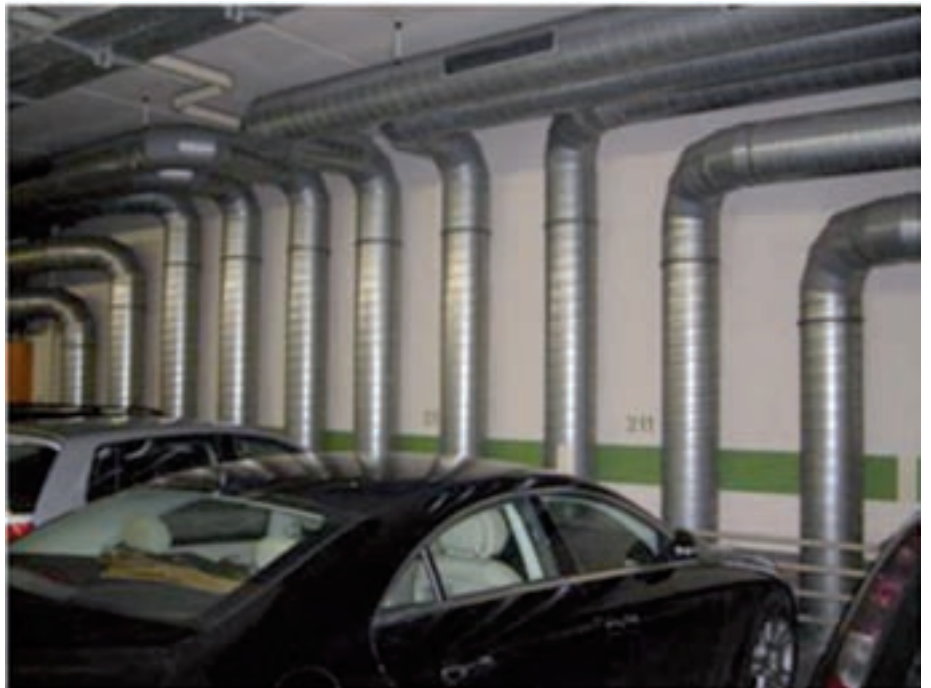
Bild 6: Abluftrohre in einer Tiefgarage
