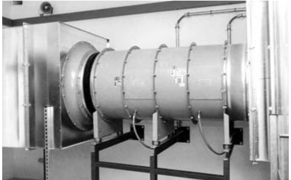
Bild 1: Entrauchungs-Axialventilator für die Garagenlüftung Typ BVZAXN 12/56/560 für F400 (geprüft nach EN 12101, T3 und CE 0761-CPD 0011) im Parkhaus des Flughafens Stuttgart.
