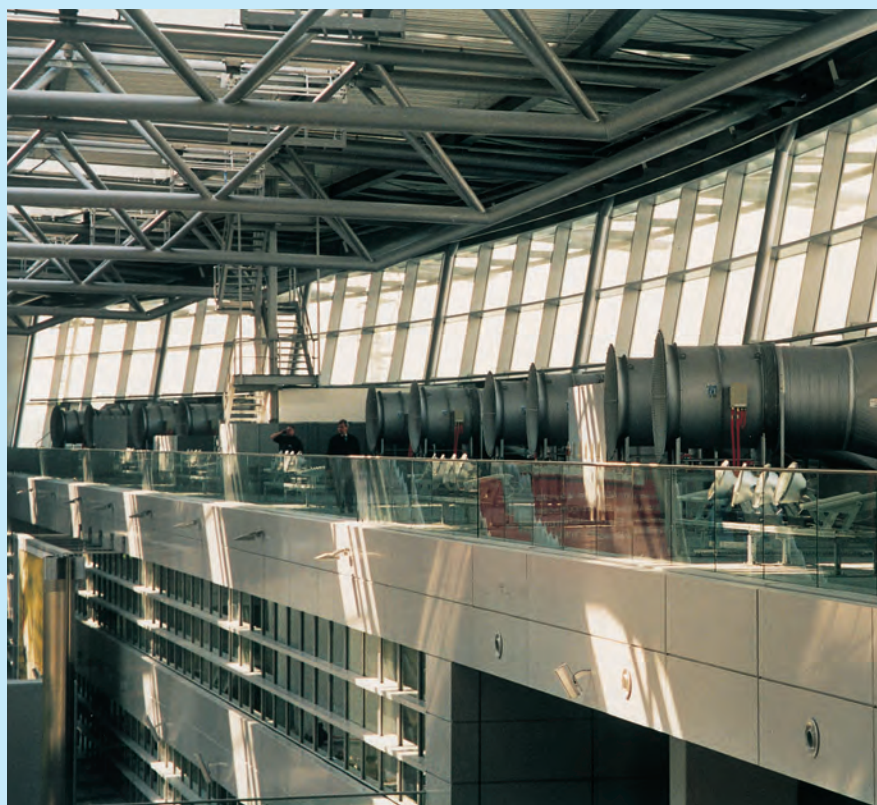
24 Entrauchungs-Axialventilatoren BVAXN 1250 - F 400 auf der Empore der Abfertigungshalle des Flughafens Düsseldorf
