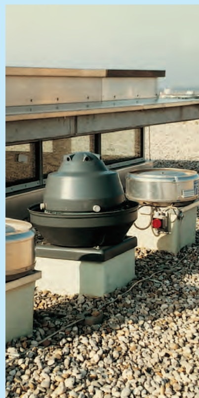
Dachventilatoren der Baureihen DRVF-K und DRV (Flughafen München)
