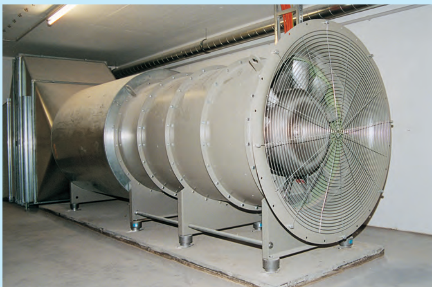
Entrauchungs-Axialventilatoren Typ BVZAX 9/56/1000 - F 400 (Tiefgarage, Hauptbahnhof Berlin)
