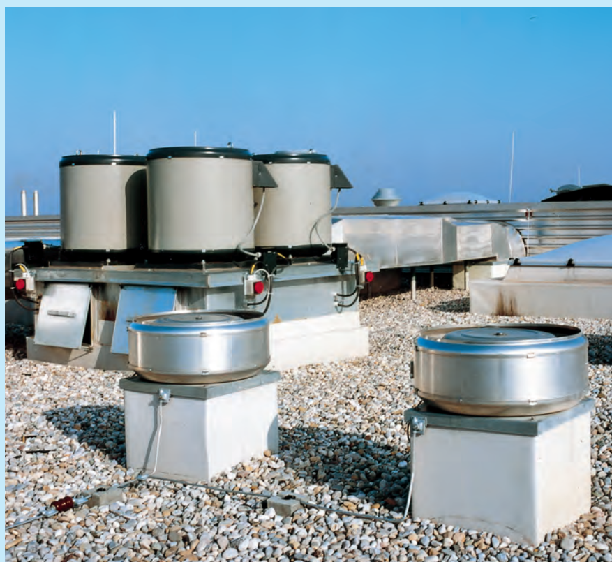
Dachventilatoren der Baureihen BVD und DRV (Franz-Joseph-Strauß-Flughafen, München)
