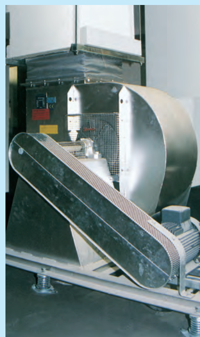
Entrauchungs-Radialventilator BVRA 560 - F 600 (Geschäftshaus im Weberpark/ Babelsberg)
